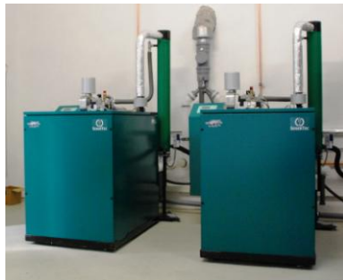
Mini-BHKWs im Heizungsraum
